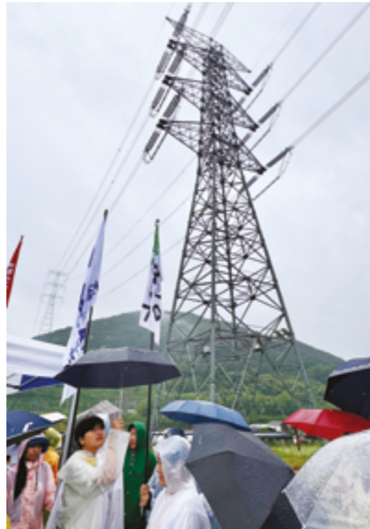
밀양 765kV 송전탑
