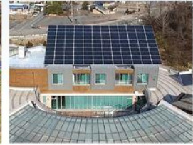
건축물 활용 태양광
