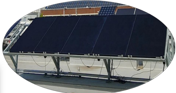
수상 및 해상 적용을 위한 기와형 태양광 모듈 Test Site 가동 중
